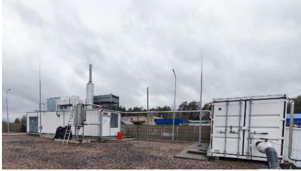
Рисунок 2 – Установка по получению свалочного газа и производству из него электрической и тепловой энергии на полигоне твердых бытовых отходов Ново-Милеевка Могилевского района
